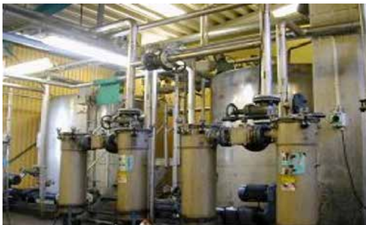
Figura N° 6: Sistema de tratamiento de aguas contaminadas.
