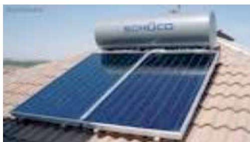
Figura N° 2: Instalación solar térmica en el techo de una vivienda.
